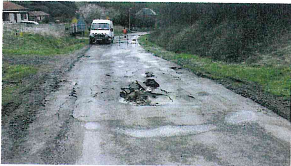
Fuite à Clémensat sur conduite DN250 mm
