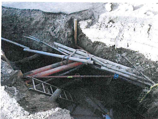
Casse par une entreprise sur chantier Assainissement aux Martres de Veyre
